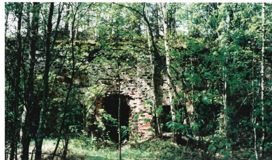
Eteläisen ammusvaraston rapautunutta tiilistä etuseinää.
